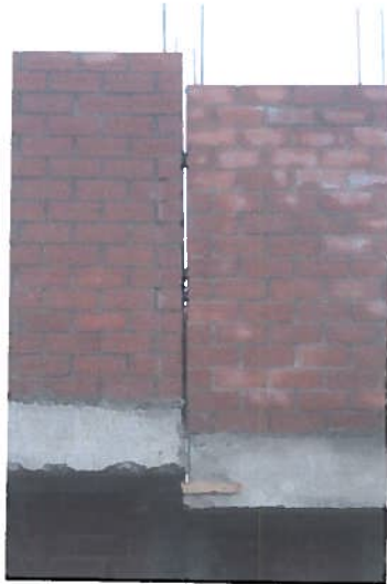
Foto N° 14 Restos de materiales en espacio entre viviendas y ausencia de solución impermeable.
