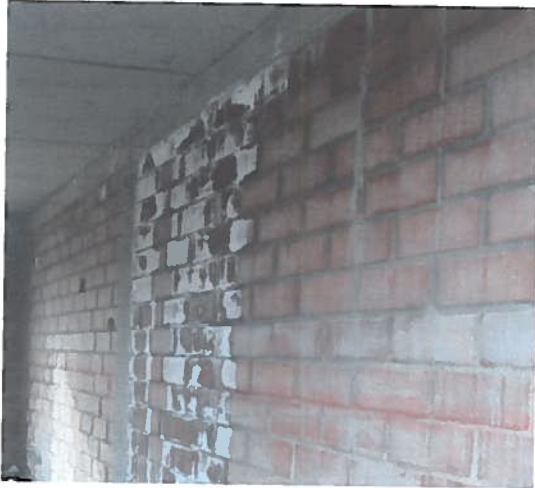
Foto N° 12 Presencia de humedad y afloramiento de sales en muros.
