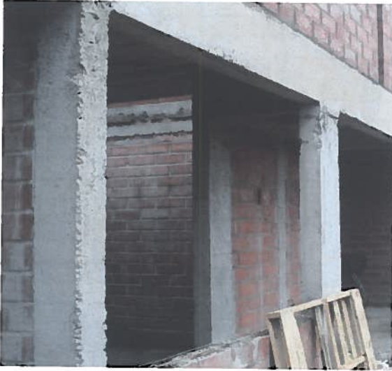
Foto N° 18 Desprendimiento de bordes de pilares.
