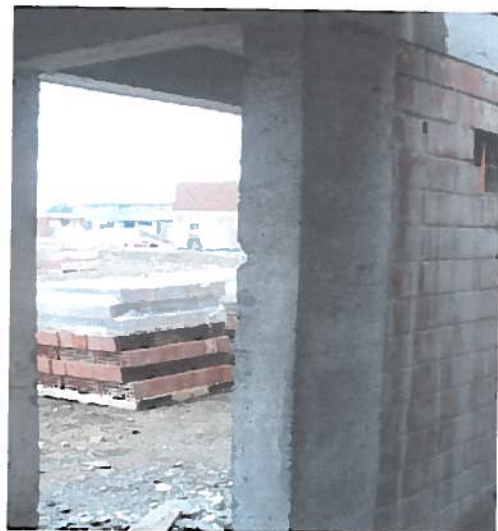
Foto N° 17 Porosidad del hormigón.
