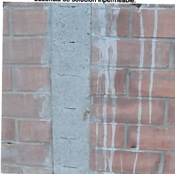
Foto N° 16 Armadura a la vista, ausencia de separadores de moldaje.
