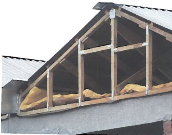
Foto N° 27 Cubiertas sin fieltro bajo la plancha de la techumbre.
