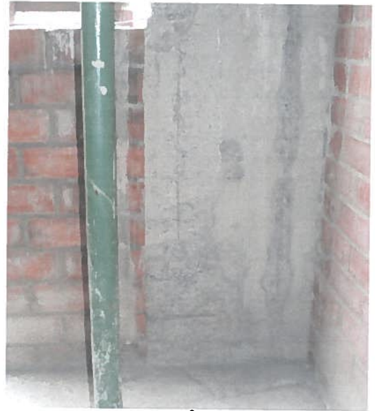
Foto N° 19 Nido de piedra y amadura a la vista.
