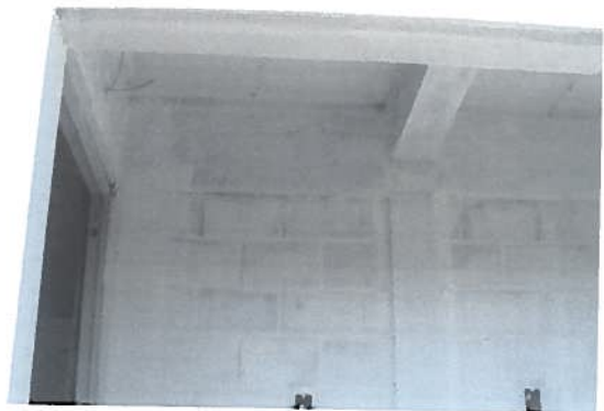
Foto N° 28 Cortagotera antes del tratamiento
