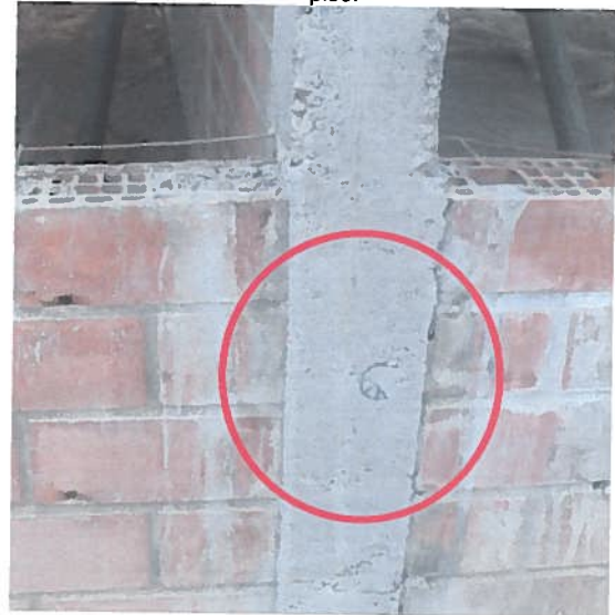
Foto N° 15 Separadores mal instalados.
