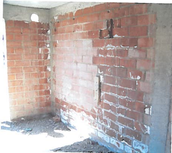
Foto N° 23 Humedad entre muros de viviendas 99 y 100.
