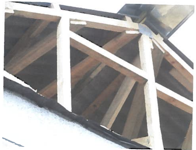
Foto N° 26 Cubiertas sin fieltro bajo la plancha de la techumbre.
