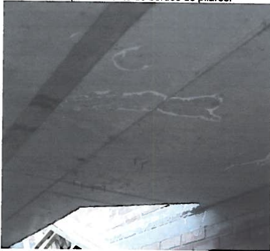
Foto N° 20 Eflorescencias en losa de segundo piso.
