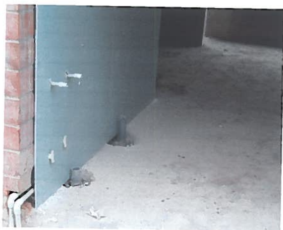
Foto N° 33 Perforación de radier en descargas de alcantarillado que interrumpe polietileno
