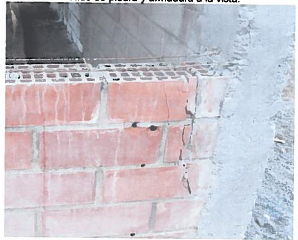
Foto N° 21 Quiebre de ladrillos en encuentro con pilares.
