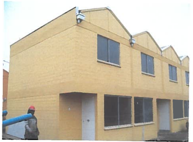
Foto N° 2 Casa Piloto sin bajadas de aguas lluvias y ventilación de techumbre.
