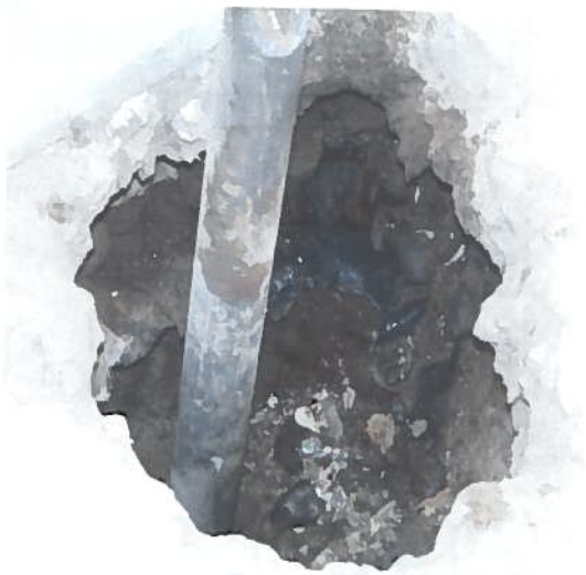
Foto N° 30 Perforación de radier en descargas de alcantarillado que interrumpe polietileno
