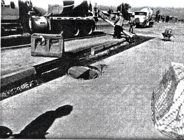
Fotografía N°3 Obra sin cierre provisorio. Avenida Dorsal con calle Lemura.
