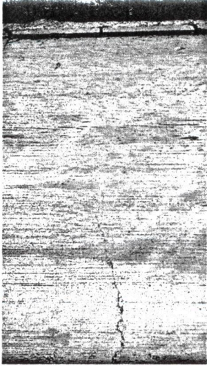
Fotografía N° 13 Lugar: Pje. Uno, frente N°612, La Reina. Observación: Fisura
