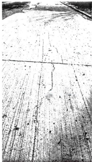
Fotografía N° 1 Lugar: Pje. Río Lauca, frente N°357, La Reina. Observación: Fisuras
