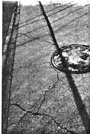
Fotografía N° 17 Lugar: Pasaje Enrique Vergara Pinto, en esquina Av. Gabriela Oriente, Puente Alto. Observación: Fisuras y grietas.
