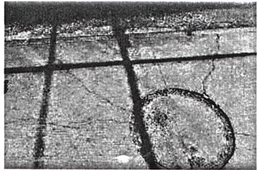
Fotografía N° 14 Lugar: Pasaje Padre Francisco Gun Bayer, en esquina Av. Gabriela Oriente, Puente Alto. Observación: Fisura.
