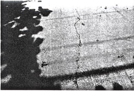
Fotografía N° 13 Lugar: Pasaje Padre Francisco Gun Bayer, frente N° 3.308, Puente Alto. Observación: Grieta.
